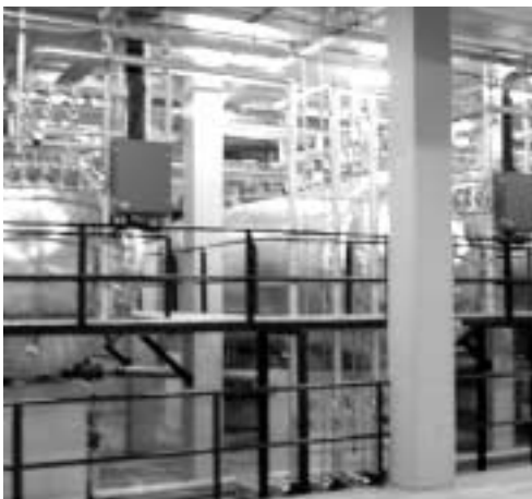
Tanques para tratamiento de efluentes
