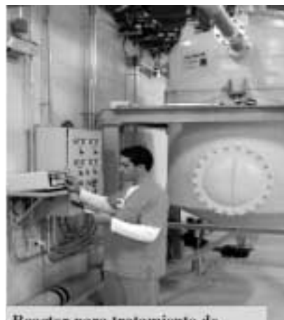
Reactor para tratamiento de efluentes de EEB
